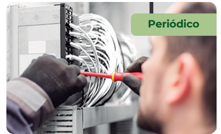
NR 10 Curso complementar – Segurança no Sistema Elétrico de Potência (SEP) e em suas proximidades - Periódico
