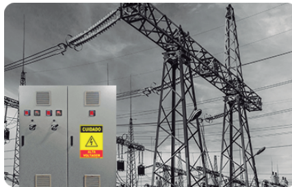
NR 10 Curso complementar – Segurança no Sistema Elétrico de Potência (SEP) e suas proximidades Iniciação
